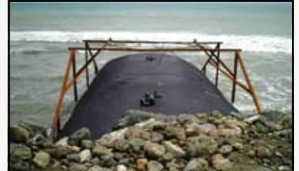
Sistemas de Geotube® seguras por uma armação de ferro aquando o seu enchimento
